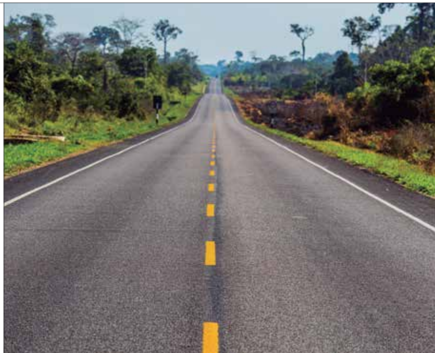
El concesionario está obligado a realizar el mantenimiento de la carretera con el objeto que ésta se encuentre en óptimas condiciones.
