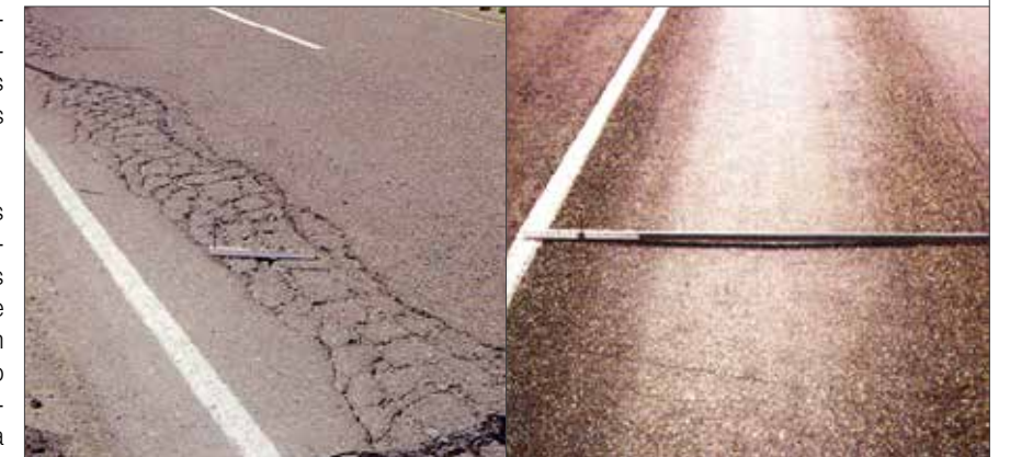
Figura 3.a Fisuras por Fatiga en la Huella
