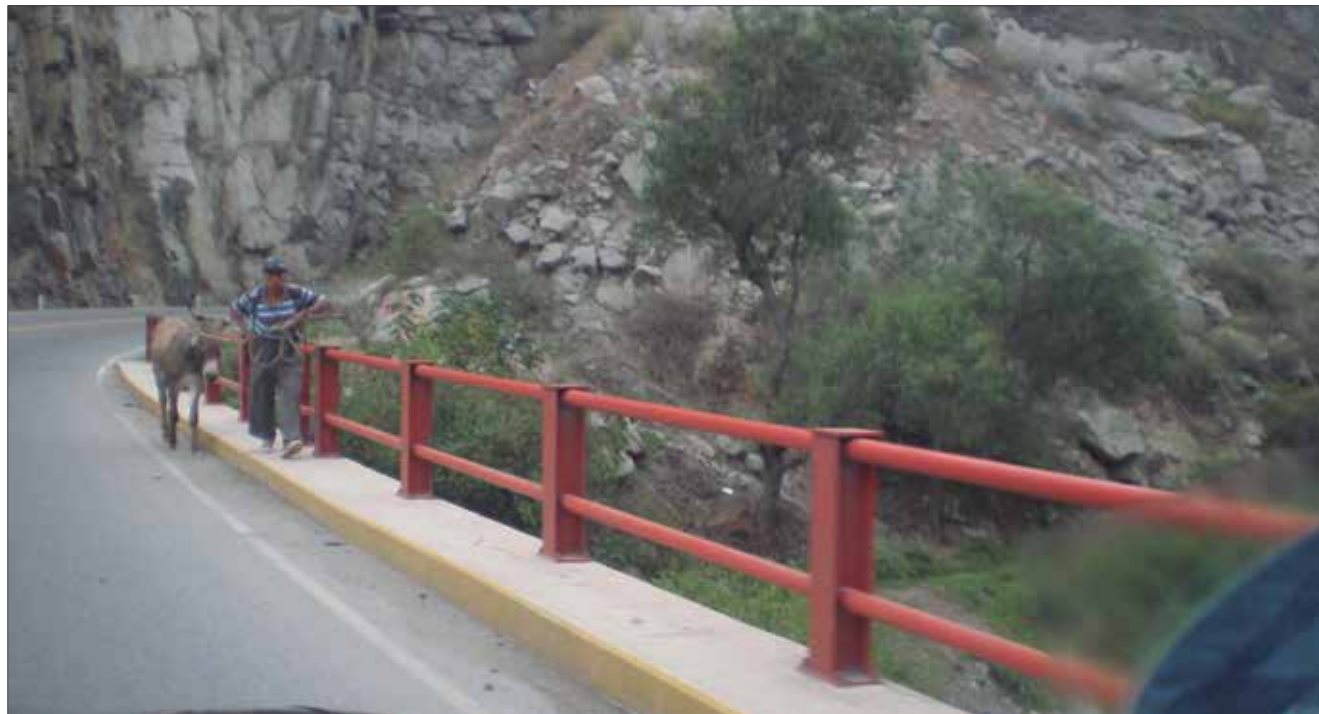
El peatón y su acémila pueden sufrir serio accidente por circular en una zona indebida. El puente no tiene un lugar adecuado para el tránsito peatonal.
