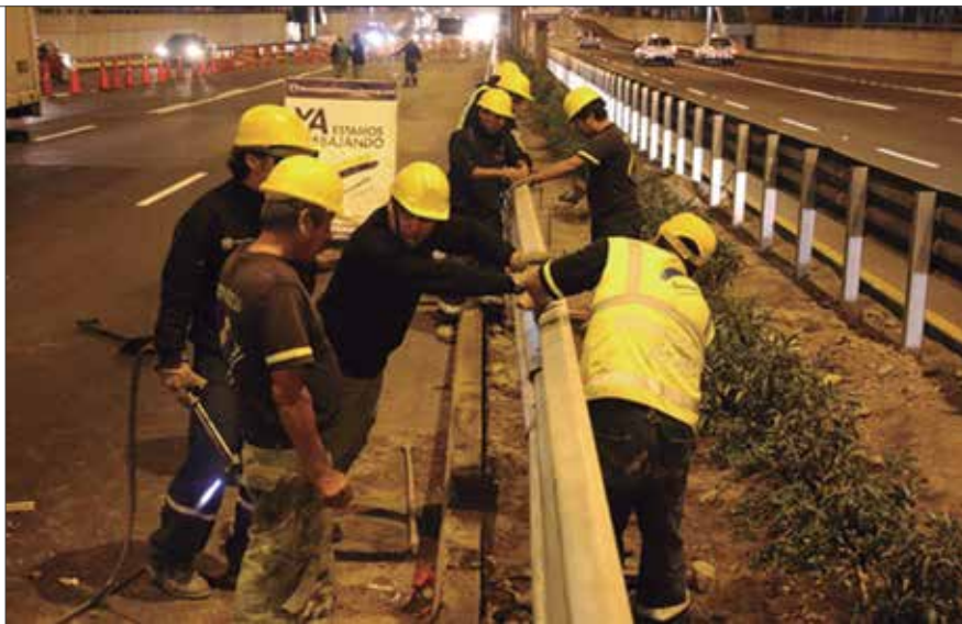
Instalación inadecuada de acuerdo al Manual de Instalación.
