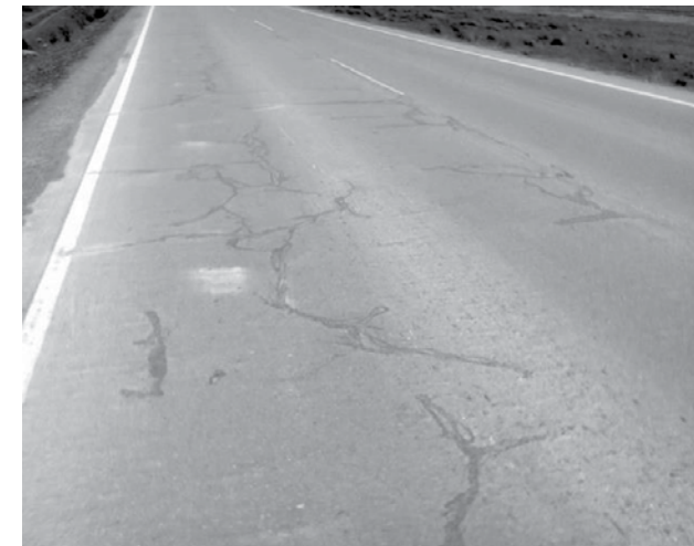
Fotografía 1: Fisuras masivas km 37+690, La Oroya- Dv. Cerro de Pasco
