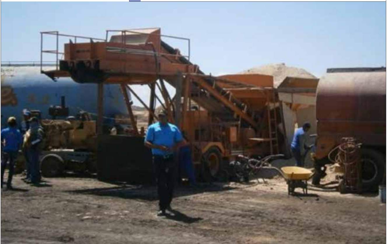
Figura 4. Planta mezcladora semi-portátil instalada en la obra.
