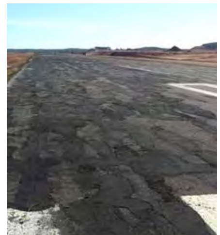
Figura 2 Condición previa del pavimento y luego de tratamiento de grietas.
