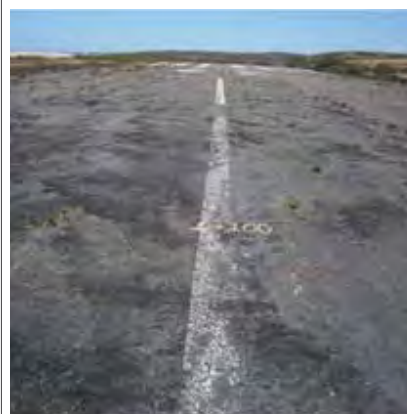
Acciones preparatorias: Sellado y relleno de grietas con EA y mortero de EA con arena.
