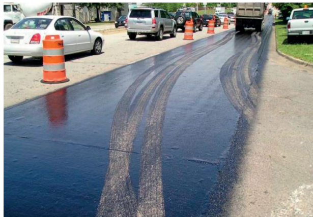
Figura 2. Fenómeno de tracking en un riego de liga convencional. El paso de los neumáticos puede levantar y desplazar parte del ligante aplicado, generando una distribución irregular antes de la colocación de la mezcla asfáltica.
